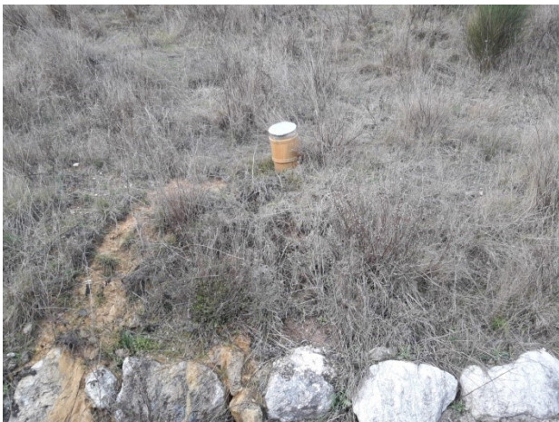
Photo 33 : Débordement au regard n°5 Sud (16/02/21)
