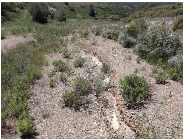
Photo 32 : Point de vue n°3 – détérioration piste flanc nord-ouest (25/05/21)
