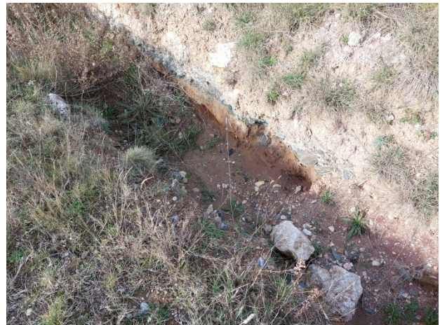
Photo 39 : Désordre n°7 - Fossé de collecte des eaux pluviales - Sables non recouverts (05/01/22)
