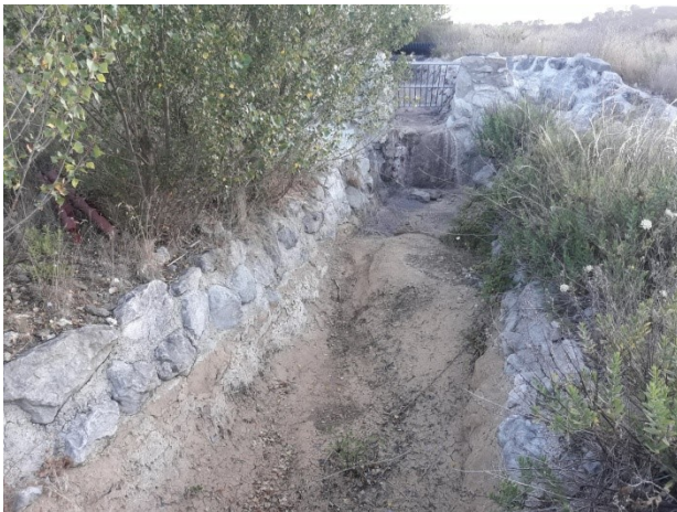
Photo 48 : Bassin de dissipation (19/07/21)
