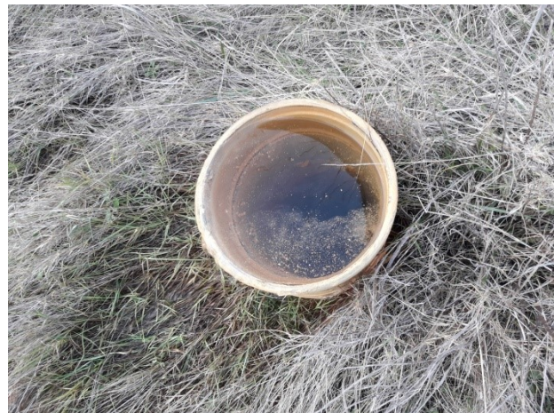
Photo 34 : Colmatage du drain de collecte Sud (16/02/21)
