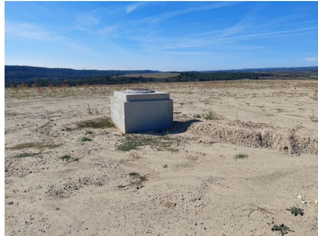
Photo 2 : Puits protégé par un regard bétonné (13/10/21)
