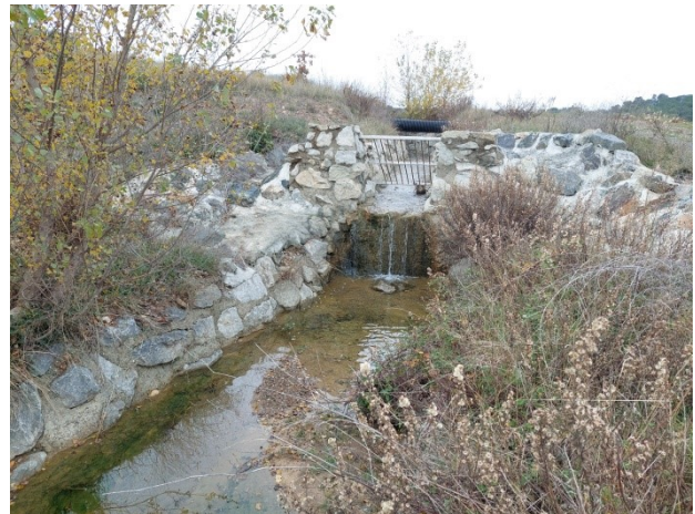
Photo 49 : Bassin de dissipation (29/11/21)
