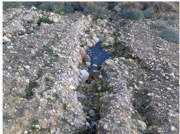
Photo 22 : Erosion jusqu'à l'accroche terre (14/12/21)
