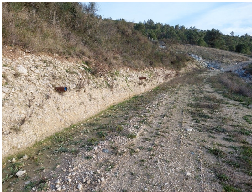
Photo 18 : Drains sub-horizontaux sur le talus aval du flanc ouest (14/12/21)
