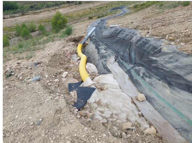
Photo 13 : Déchaussement d'un drain - Flanc ouest (09/09/21)
