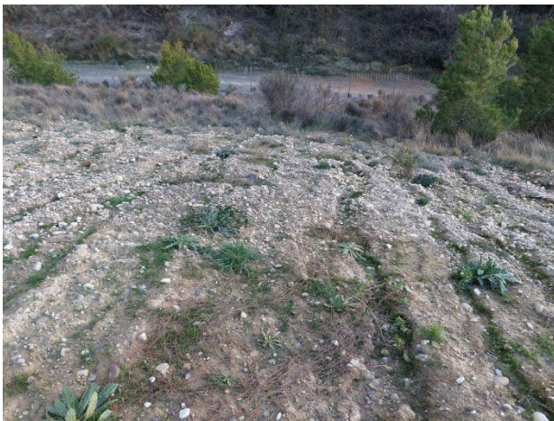
Photo 21 : Traces d'érosion superficielles (14/12/21)
