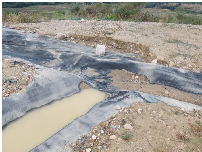
Photo 26 : Erosion en bordure de géomembrane (09/09/21)
