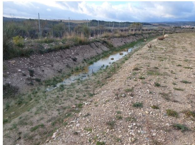
Photo 15 : Caniveau avec stagnation d'eau + 248 m NGF (14/12/21)
