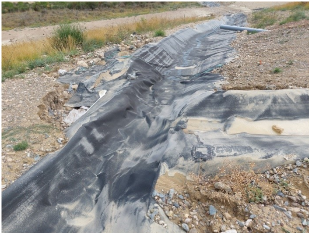
Photo 12 : Fluage de la géomembrane - Flanc Ouest (09/09/21)
